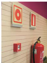
Extinción y Emergencia
